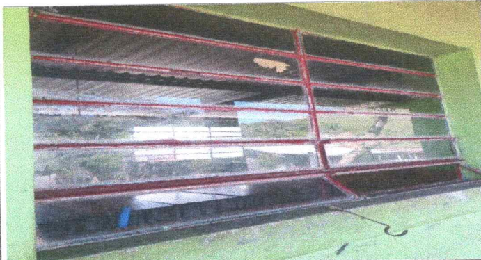
Foto 3: Se observa vidrios quebrados y balcones oxidados,
