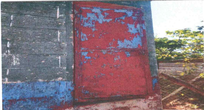
Foto 3: Se observa la puerta de la letrina deteriorado.
