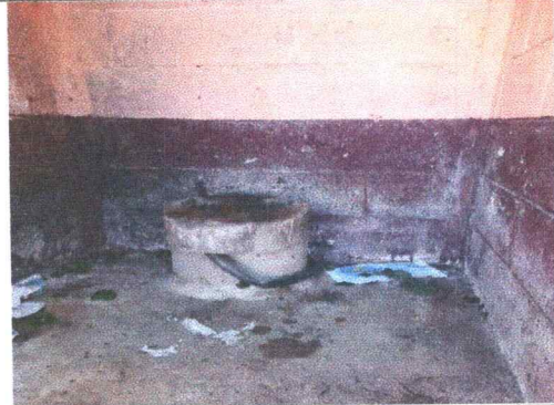
Foto 2: El inodoro está deteriorado, se necesita cambiar.
