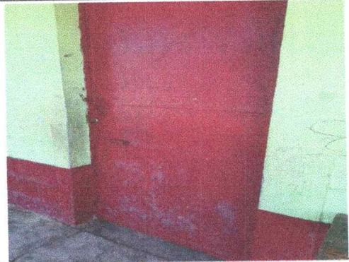
Foto 2: Se observa deterioro de pintura
