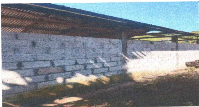
Foto 5: se observa la cocina de escuela por falta de repello.
