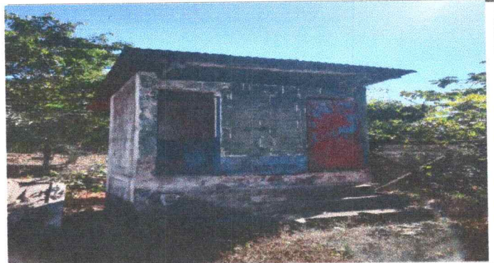
Foto 4: se observa desprendimiento de pintura de la pared de la letrina.
